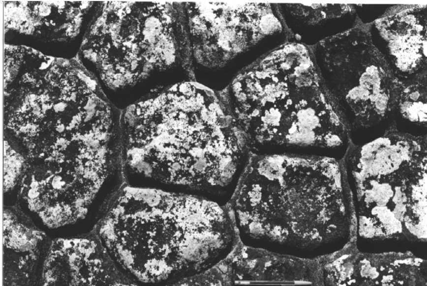
Figura 8: juntas poligonais atribuídas à insolação e abertas por subseqüente intemperismo ao longo das superfícies de ruptura.
