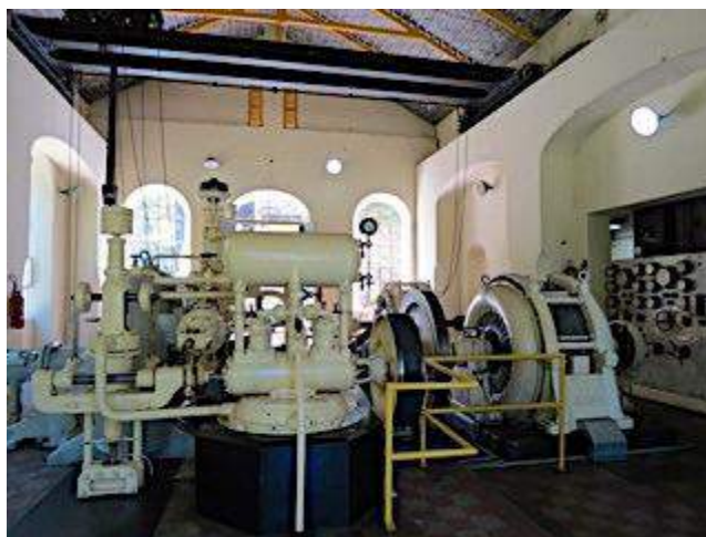
Figura 2. Interior da casa das máquinas.
