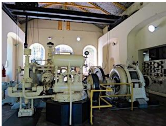
Figura 2. Interior da casa das máquinas.
