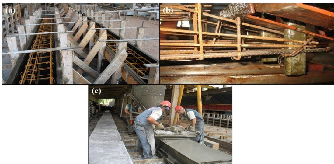
Figura 1 – (a) Formas e armaduras aguardando concretagem em vigas L; (b) Detalhe do estreitamento da seção transversal, conseqüentemente o aumento da taxa de armadura, nas extremidades das terças e (c) Concretagem de laje-calha.
