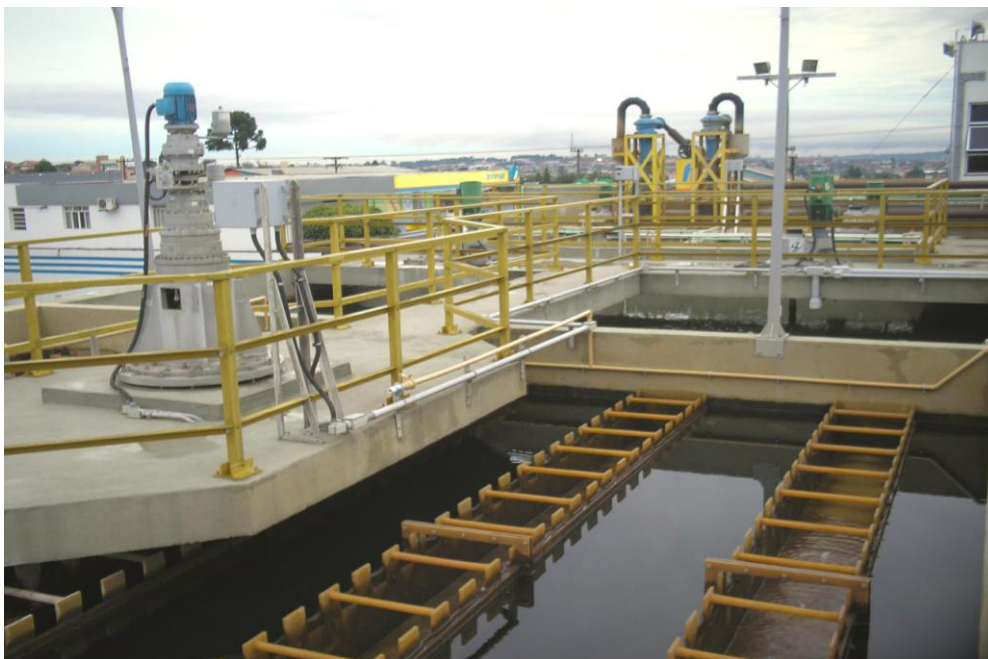
Figura 4 - Visão geral do processo de clarificação estabilizada com microareia, com destaque para o decantador e calhas de coleta de água decantada.
