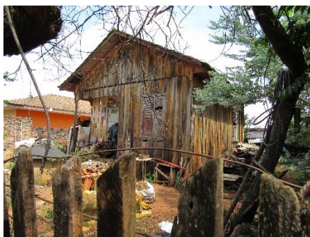
Figura 8 - Casa abandonada (Rua Franco Grillo) Fonte: foto do autor, abril de 2016
