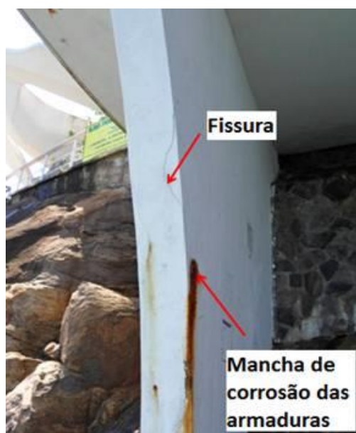
Figura 10 - Manifestações patológicas observadas na estrutura da plataforma.
