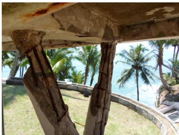
Figura 7 - Corrosão das armaduras nos pilares da passarela de acesso à residência.
