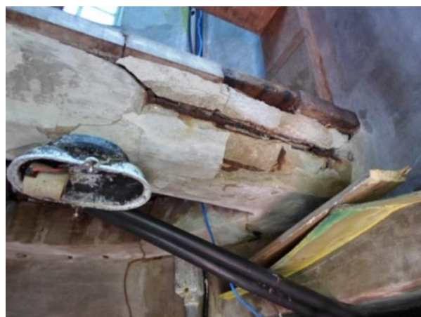
Figura 8 - Corrosão das armaduras de vigas internas no farol.
