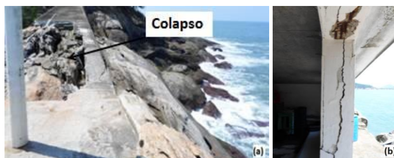
Figura 6 - Manifestações patológicas verificadas na estrutura da oficina. (a) Colapso parcial de uma laje devido à corrosão; (b) Fissuração e corrosão em pilar e viga.
