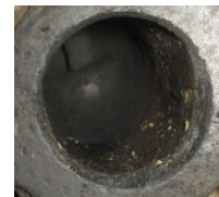
2c. Duto de escape do E-3
