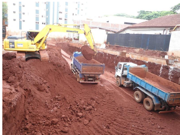
Figura 7 - Escavação sem sinalização.
