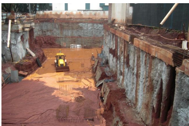
Figura 11 – Local alagado por despejo de esgoto e água da rede urbana.
