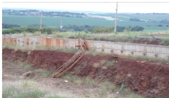
Figura 04 – Contorno Norte - Escada de acesso à escavação em condições precárias.
