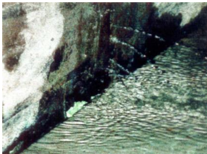
Figura 1 – Vazamentos em estrutura de concreto. FONTE: Soluções de engenharia.
