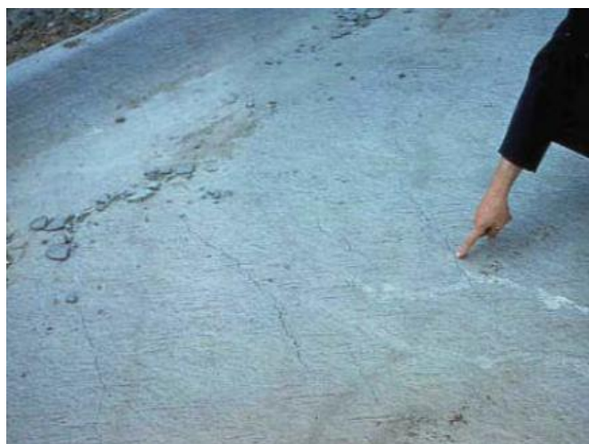
Figura 2 – Fissuras causadas por retração após a má cura do concreto. FONTE: Soluções de engenharia.
