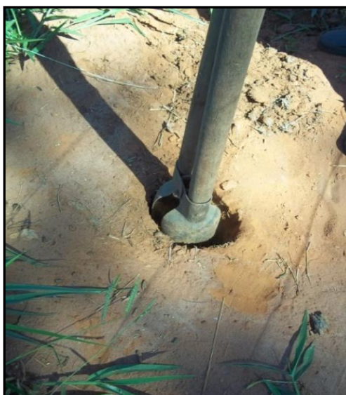
Figura 4 - Escavação realizada nos locais seleccionados à implantação dos marcos de concreto. Fonte: Autores (2013).
