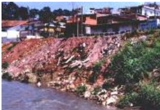
Figura 3 – Resíduos de construção civil em corpos d'água Fonte: SHINTANI (2012)
