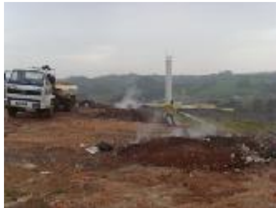
Figura 10 - Fogo em aterro de RCC
