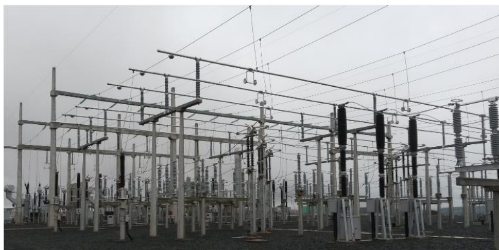
Figura 2 – Exemplo de Subestação de 230 kV
