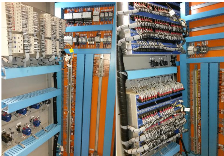
Figura 3 – Vista interna de Painéis de Proteção
