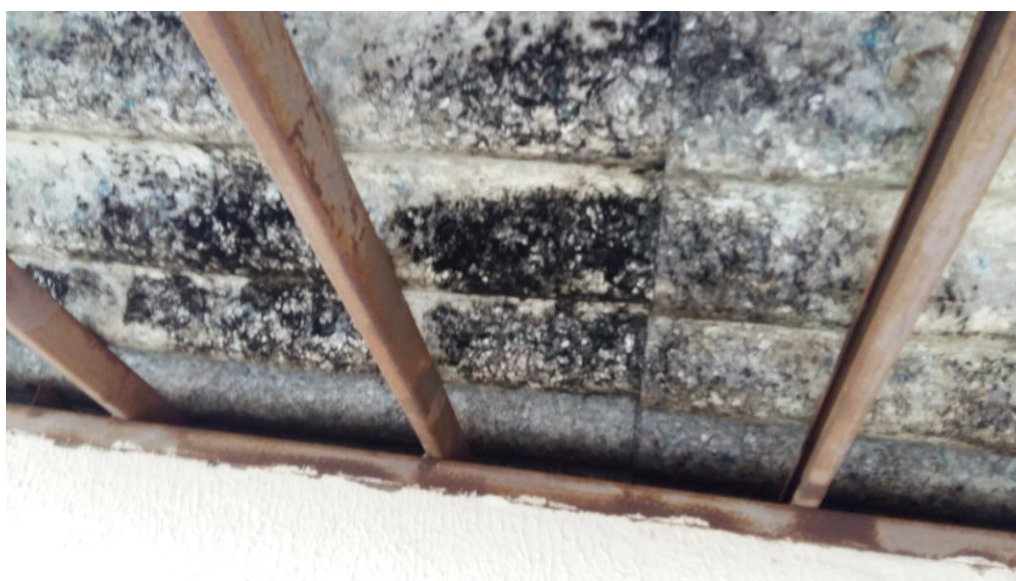
Figura 3 –Bolor em sua face interna do telhado
