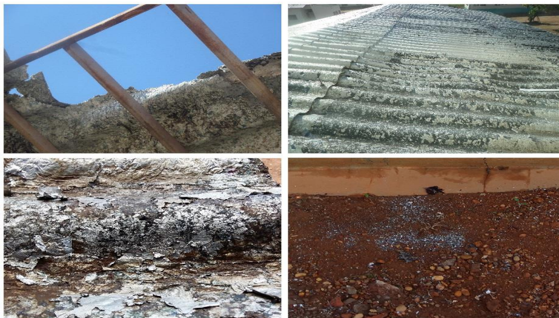
Figura 2 – Patologias telhas com idades de 6 e 10 anos de utilização
