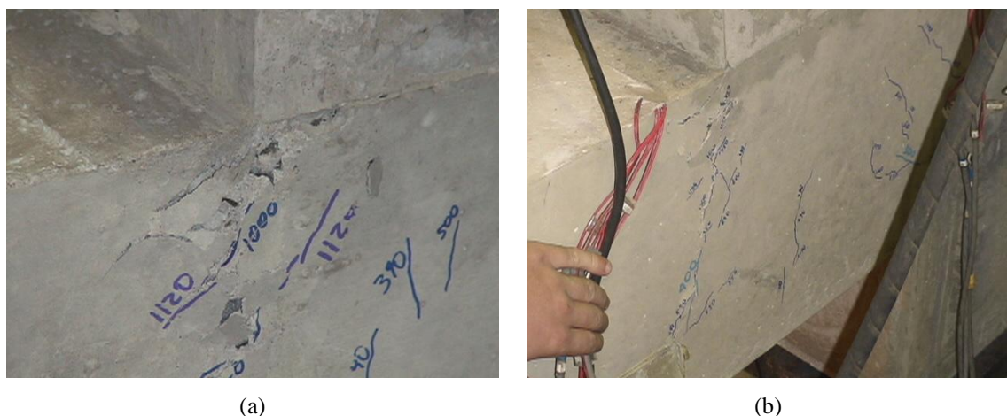
Figura 9 – Fissuras na região de encontro do bloco com o pilar e ao longo da face lateral
