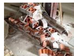
c) painel com cobogós cerâmicos com ruptura frágil e esmagamento dos componentes inferiores
