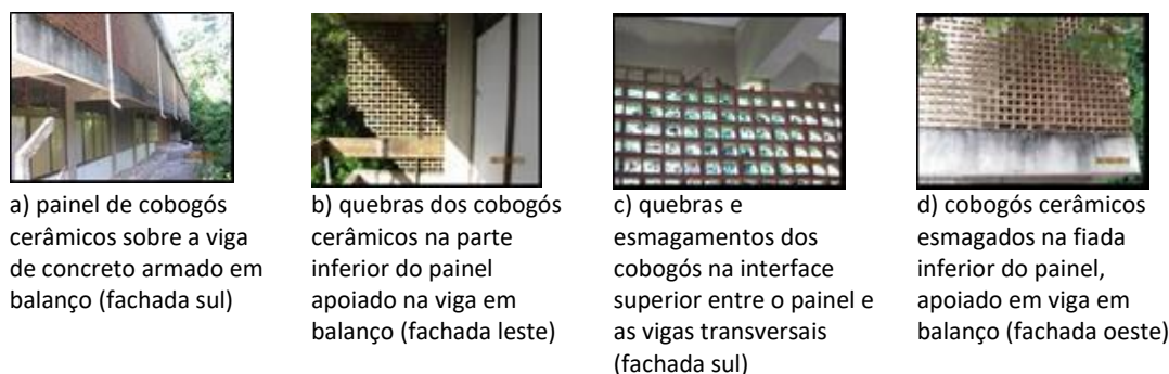
Figura 1: Patologias destacadas na interface entre painéis de cobogós cerâmicos e estrutura de concreto armado Fonte: Acervo dos autores
