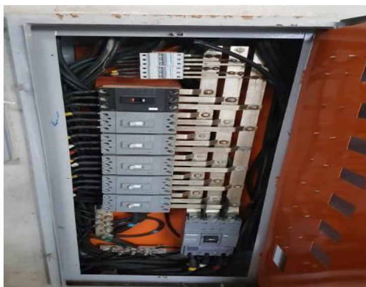
Figura 15 - Quadro de entrada de energia.
