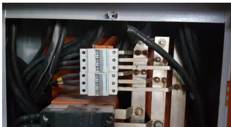
Figura 16 - Parafusos enferrujados no barramento.
