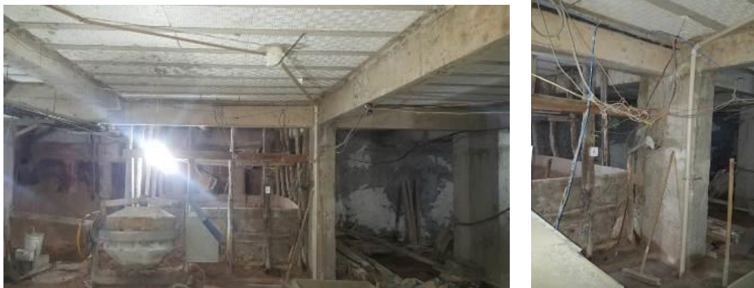
Figura 13 - Método inadequado de ligação com partes vivas e fiação exposta.
