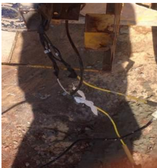
Figura 10 - Isolação de partes vivas com material inadequado.
