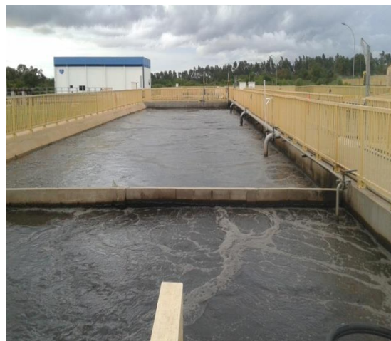
Figura 4 - Vista lateral zona aeróbia aerada.
