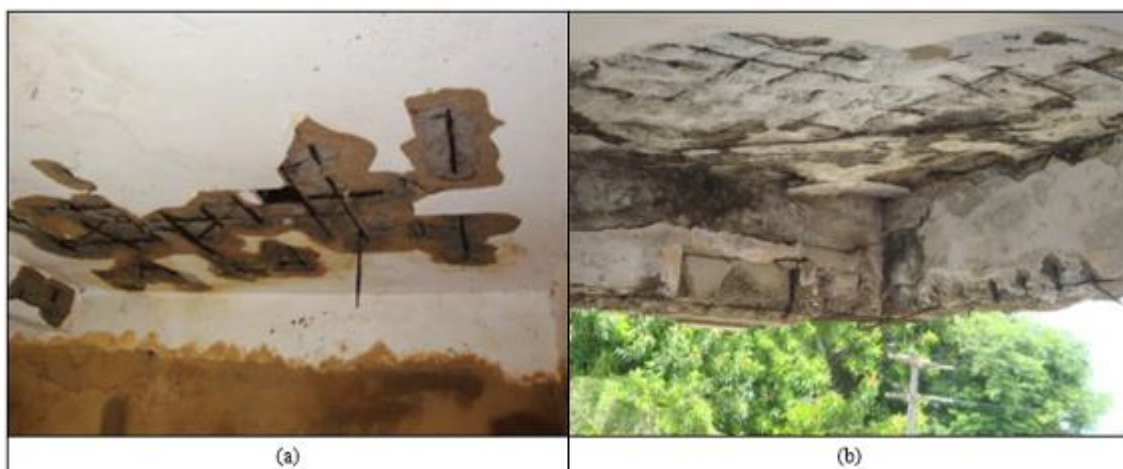
Figura 5 – Deslocamento da camada de cobertura de concreto: (a) Laje; (b) Laje e viga. Fonte: adaptado de CL Engenharia e Urbanismo (2014).
