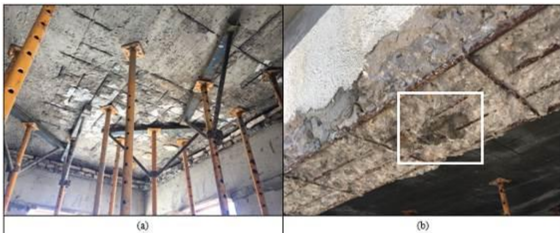
Figura 8 – Apicoamento em estruturas de concreto armado: (a) Laje; (b) Viga, com solução incolor de fenolftaleína. Fonte: autores (2018).
