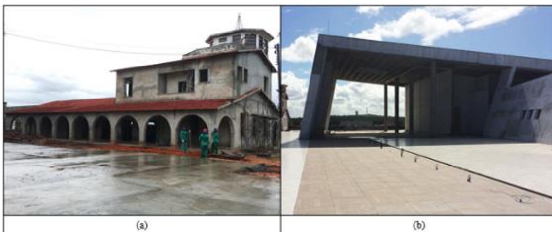
Figura 3 – Centro Cultural Rampa: (a) Museu da Rampa em recuperação estrutural; (b) Memorial do Aviador em construção. Fonte: autores (2018).
