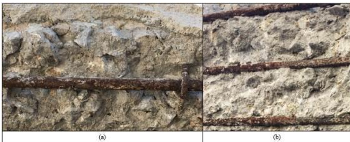
Figura 7 – Corrosão generalizada desencadeada por carbonatação em vigas. Fonte: autores (2018).
