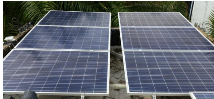
Figura 01 – GD FV de 1,5 kWp instalada no LEA-UFC.
