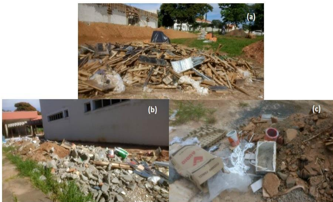
Figura 2: Resíduos gerados na obra: (a) madeira e plástico (b) concreto, metal e papelão (c) lata de tinta, embalagens de papelão e plástico.
