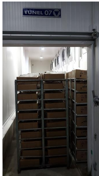
Figura 1 – Produto em caixas para congelamento
