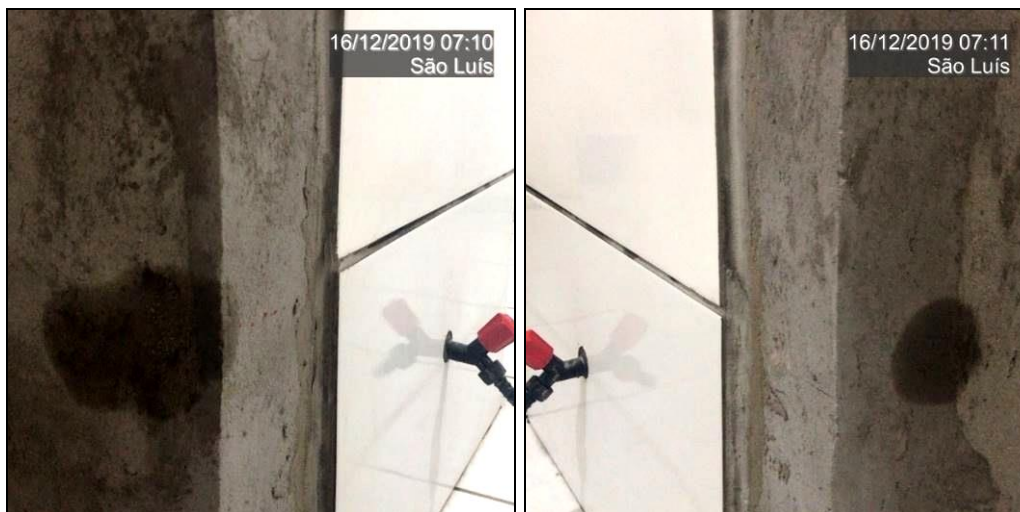
Figura 7 – Manchas de infiltração na argamassa
