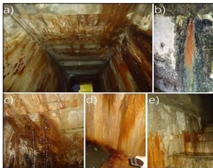
Figura 7 - Fluxo d'água no teto e paredes da galeria de drenagem (a). Eflorescência avermelhada e muita umidade na parede de concreto (b). Presença de estalactites no teto da galeria de drenagem (c). Infiltrações e eflorescência na região dos degraus e parede da galeria (d) e (e).
