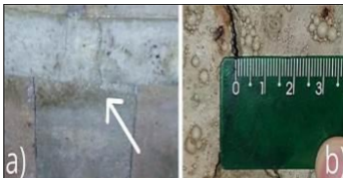
Figura 9 - Abertura na laje da galeria de drenagem (a) e (b).
