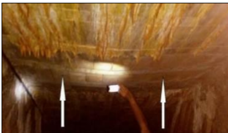
Figura 8 - Deformação na laje da galeria de drenagem.
