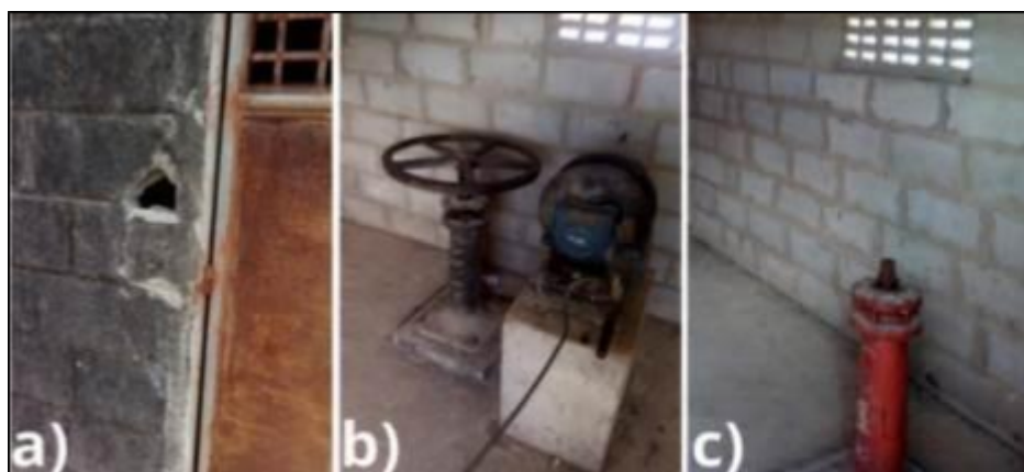
Figura 12 - Danos na torre de comando (a). Sistema de acionamento da comporta da descarga de fundo (b) Sistema de acionamento da comporta de abastecimento (c).
