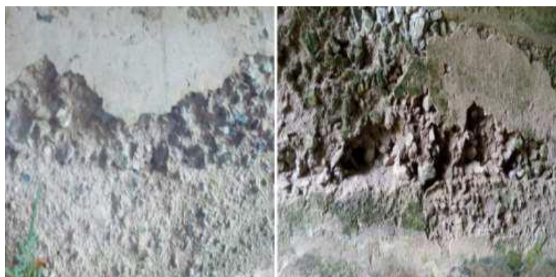
Figura 10 - Esfarelamento na galeria de drenagem.
