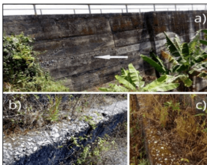
Figura 5 - Ninhos de concretagem no barramento de jusante (a). Ninhos de concretagem nos degraus do barramento esquerdo (b). Ninhos de concretagem nos degraus do barramento direito (c).
