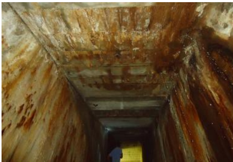
Figura 6 – Diversos pontos de infiltrações, paredes e teto com lixiviação, e corrosão da armadura do concreto.
