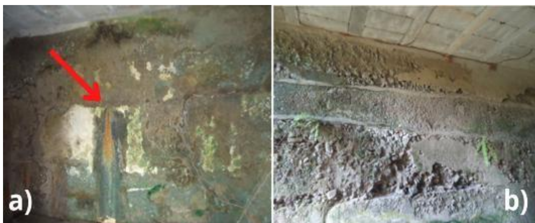
Figura 7 – Umidade e ponto de infiltração com coloração avermelhada (a). Alto grau de deterioração do concreto (b).
