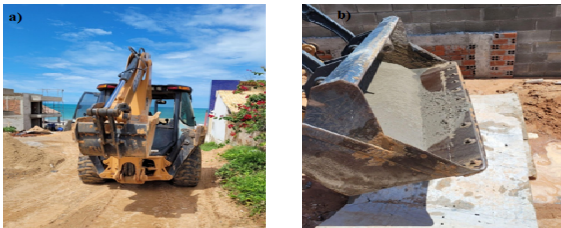
Figura 4: a) Deslocamento da retroescavadeira até o posto de serviço a ser executado; b) Argamassa chegando ao posto de serviço a ser utilizada Fonte: Acervo dos autores (2023).
