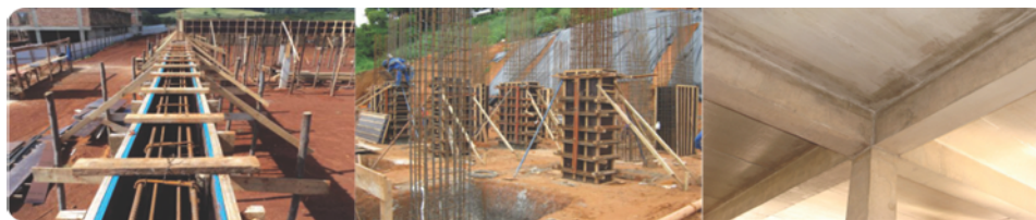
Figura 2: Elementos de viga, pilar e laje em concreto armado realizado in loco
