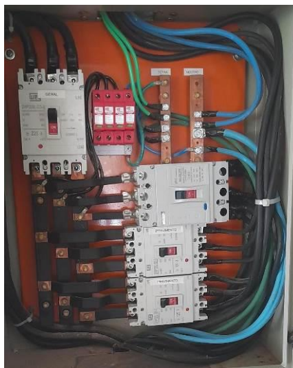
Figura 1 – Quadro de distribuição.
