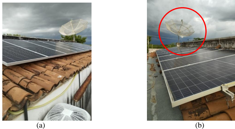
Figura 12 - (a) Instalação dos módulos para lado a do telhado; (b) Instalação dos módulos para lado b do telhado
