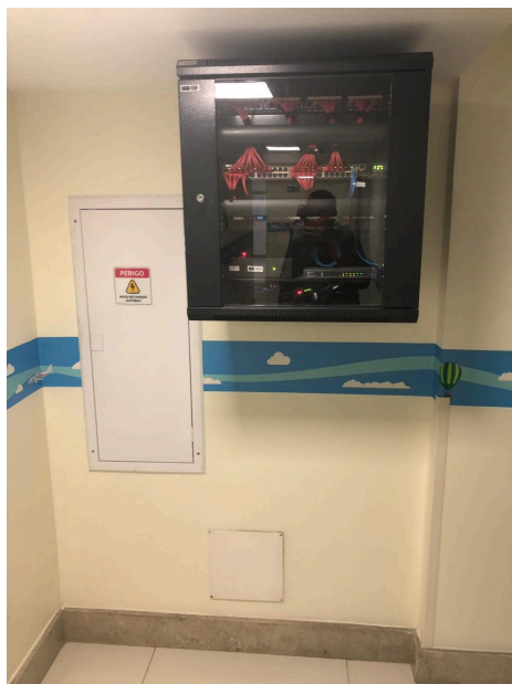
Figura 3 – Rack de 12U do pavimento térreo
