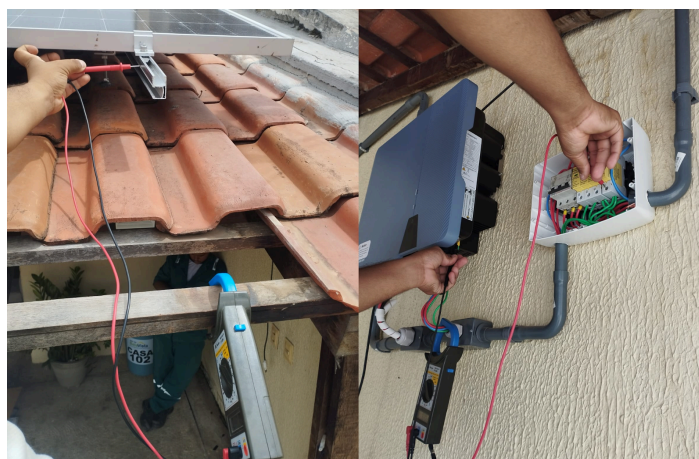
Figura 9 - Ensaio de equipotencialização nos módulos fotovoltaicos e inversor
