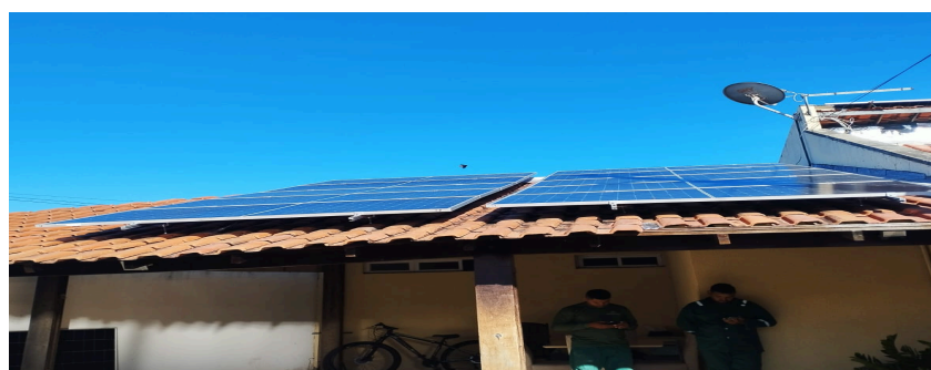
Figura 8 - Sombreamento presente nos módulos fotovoltaicos
