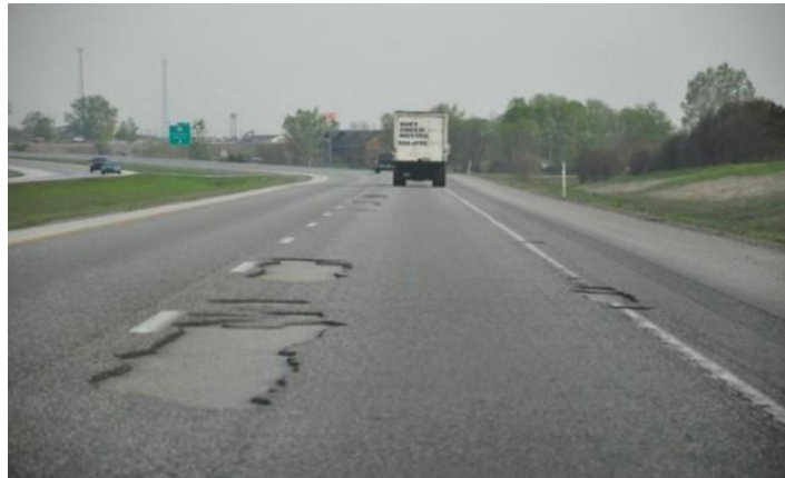
Figura 1 – Delaminação na rodovia I-65 Indiana. Fonte: Lee et al. (2013).
