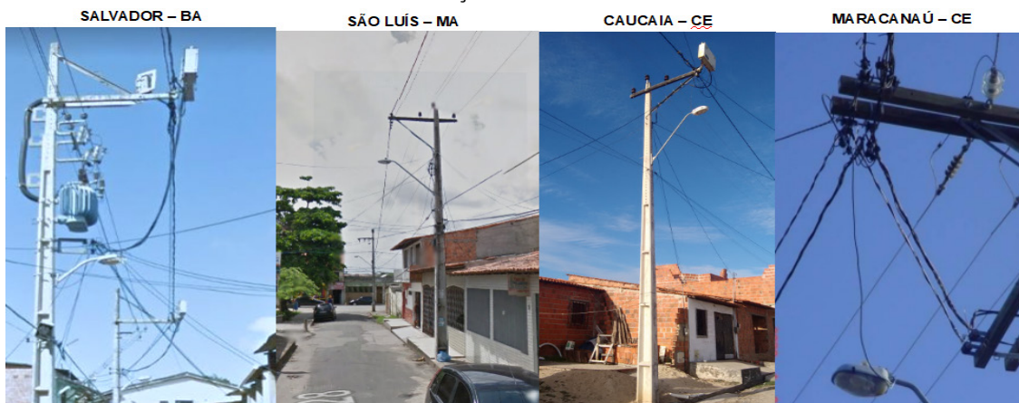
Figura 6 - Rede de alimentação da iluminação pública na mesma cruzeta da rede de distribuição elétrica.
