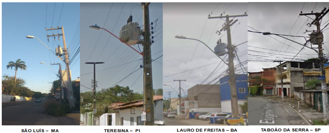
Figura 7 - Braço de luminária em contato com o transformador da rede de distribuição elétrica.
