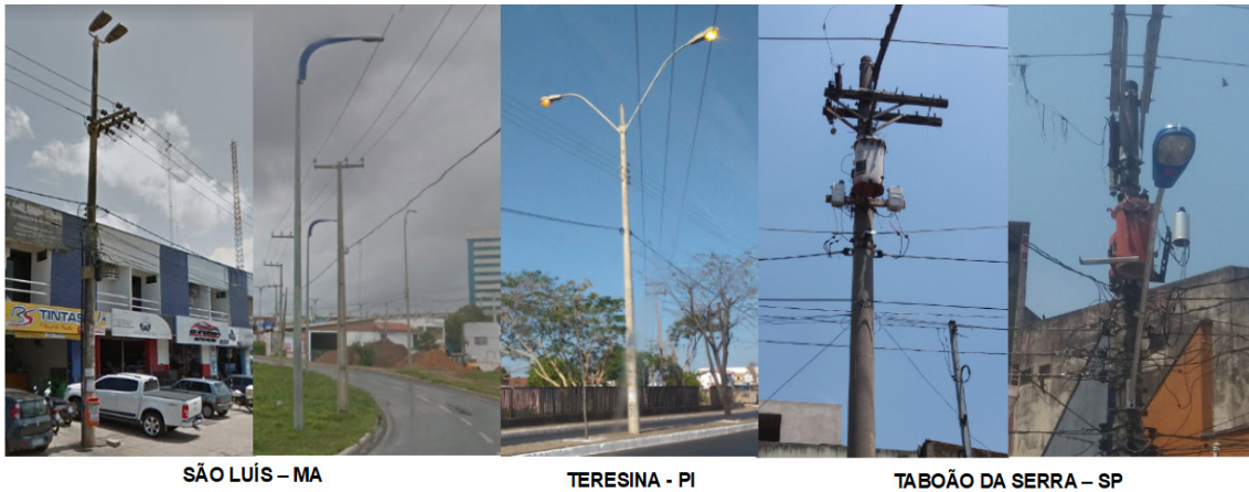
Figura 5 - Braços de luminária acima ou muito próximos das linhas de distribuição primárias de 13.800 volts.
