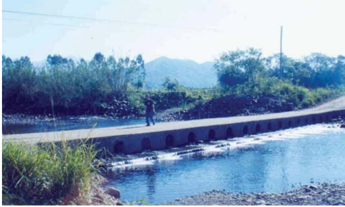
Figura 7 - Leito do rio Amola Faca no local onde foi medida a primeira seção transversal, visão para montante. Observar a restrição do fluxo por causa da construção da ponte de concreto que deixa passar a água somente através de canos de concreto. Nesta área também são extraídos clastos. Foto: Edna Luiz, ago. 2006.
