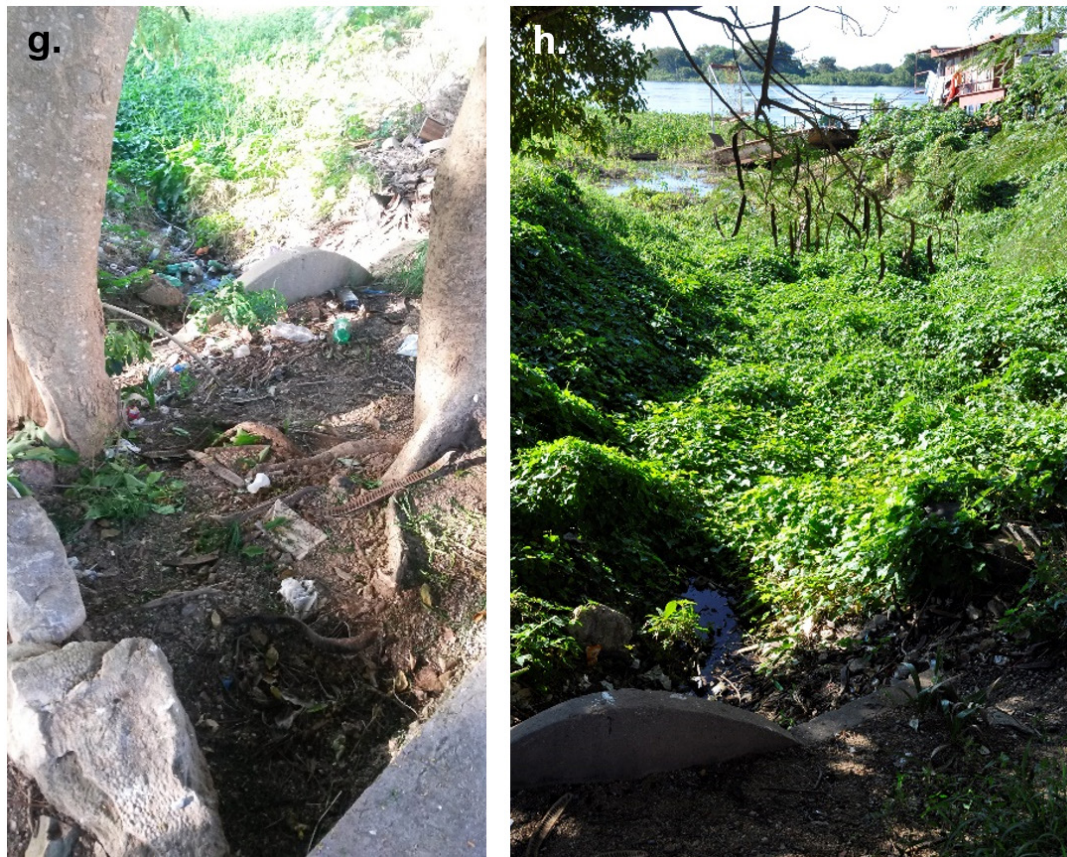
Figura 11. Lixo acumulado (g) e lançamento do esgoto diretamente no rio (h).
