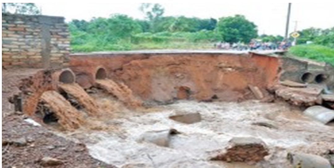
Figura 6. Córrego Canivete rompe tubulação sob a Rua José Barriga em razão de fortes chuvas que ocorreram no fim da tarde.
