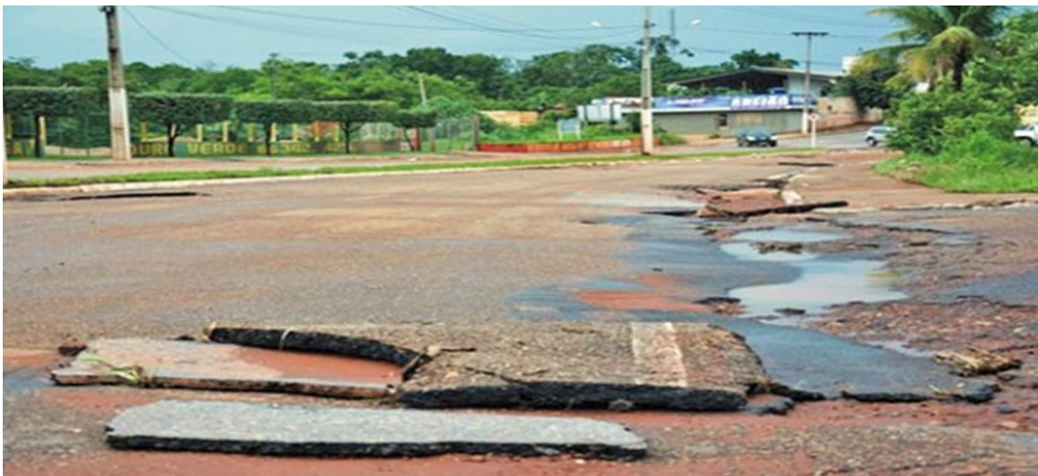
Figura 12. Asfalto arrancando pela força das águas da chuva na Rua Fernando Correa da Costa.
