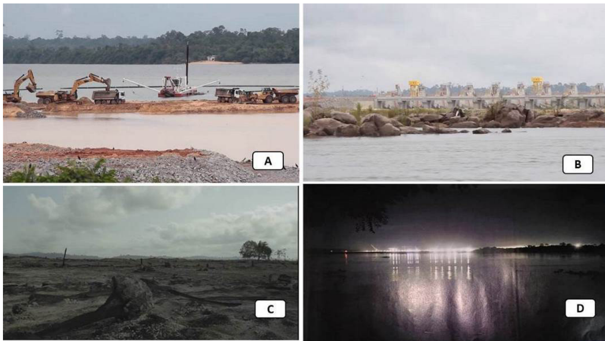
Figura 4: Canteiro de Obras da UHE de Belo Monte. A – Canteiro na calha de rio Xingu, enceradeira; B – Barragem principal, sítio Pimental; C – Área desmatada a jusante da barragem; D – Canteiro de obras à noite.
